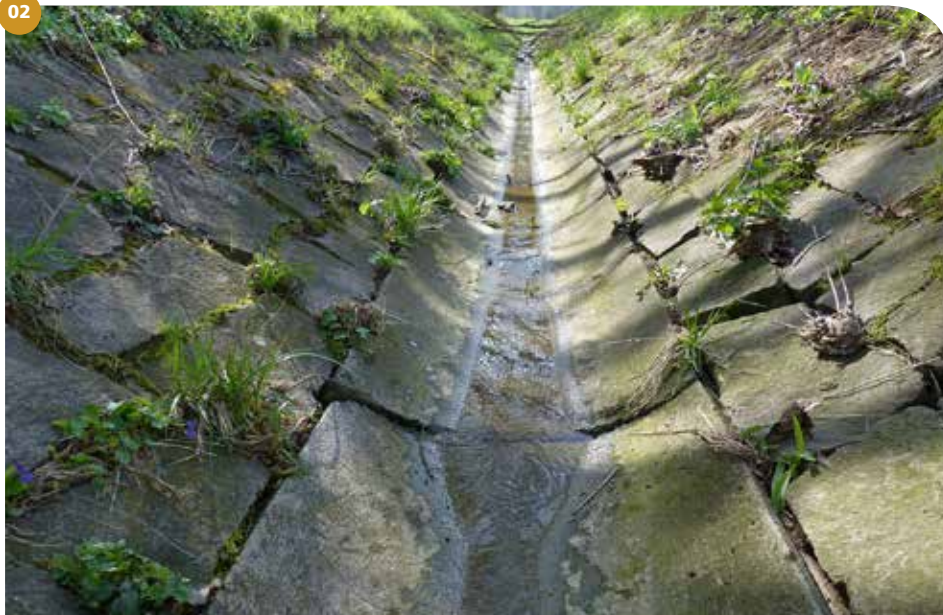
02 Im Zuge der Flurbereinigung wurde das Bachbett des Haybachs begradigt und in Betonschalen gefasst. Foto: Bodo Witzke
